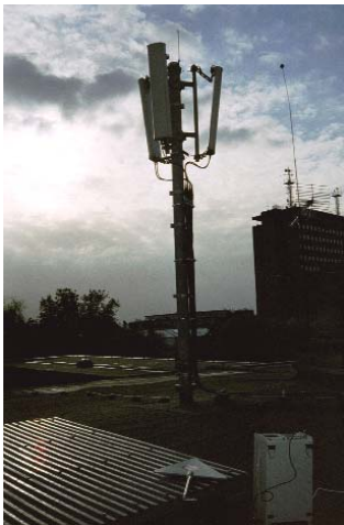
Mobilfunkanlage in Essen
